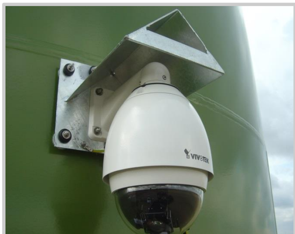
Rysunek 3. Kamera VIVOTEK zamontowana na wieży wiatraka.
